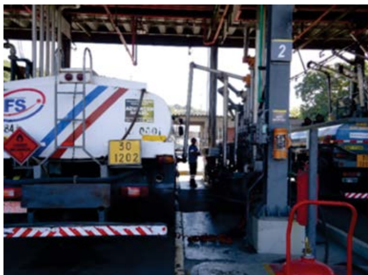
Figura 2 - Carregamento “Bottom Loading”
