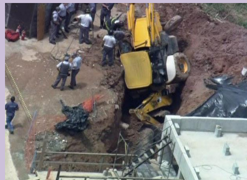
Morte no trabalho: A assessoria de imprensa da Sabesp confirmou que o acidente aconteceu em uma obra de uma estação elevatória da companhia na Rua Jaraguari. A vítima era um funcionário de uma empreiteira contratada para fazer os trabalhos no local.
