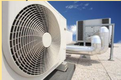
A modernização dos sistemas de ar-condicionado gera benefícios ambientais e econômicos
